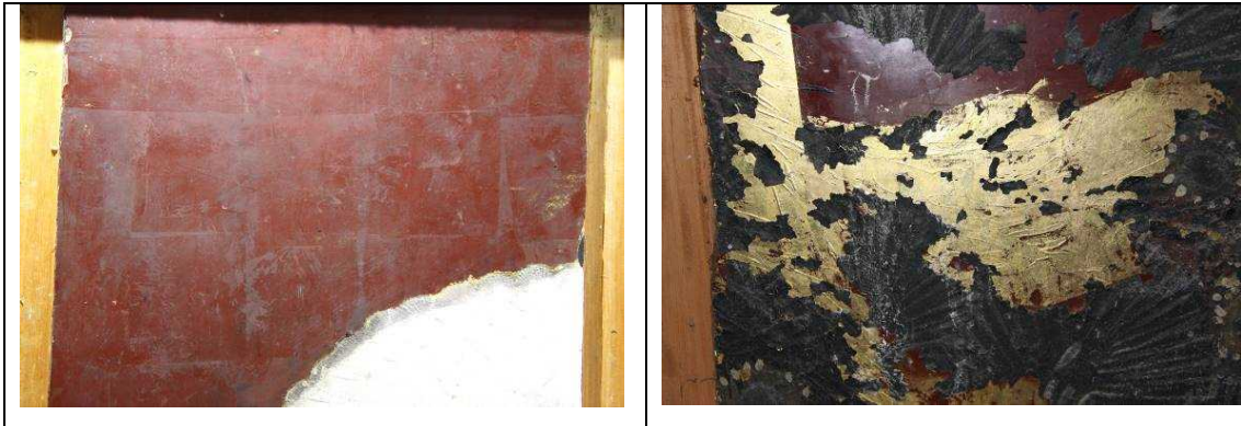
写真 24: 陽明門西側板壁面の宝暦期金箔の箔足(色吉箔を想定)
