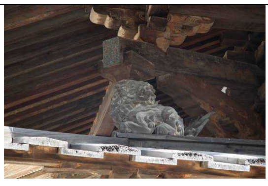
写真8:同 向肘木木口面の鍍金金具の現況
